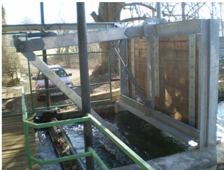
Rechenputzmaschinen auf Rahmen des Einlaufschütz montiert
